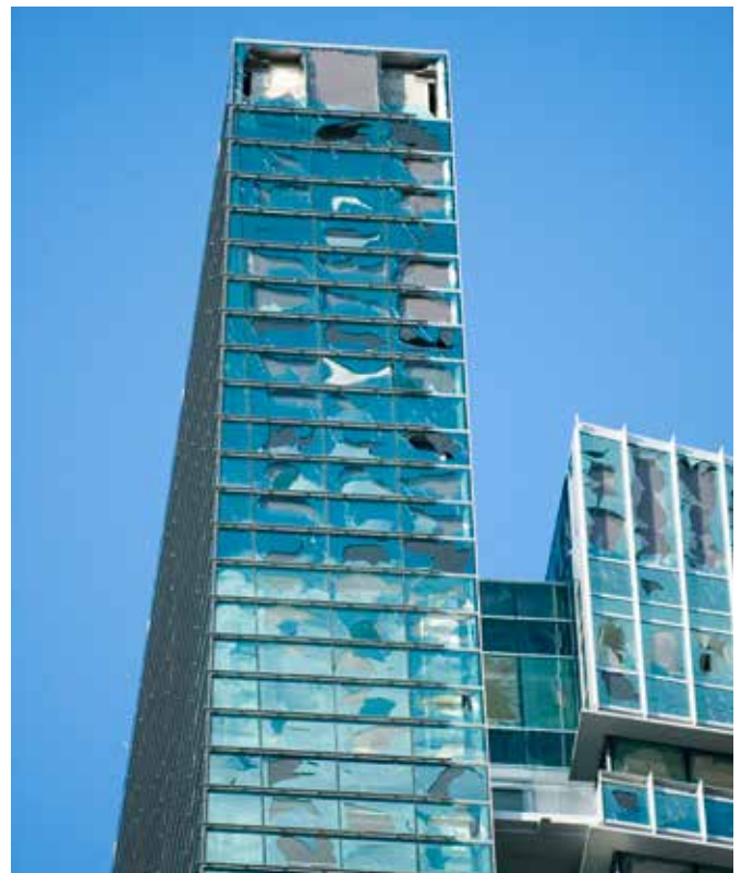
Wysoka prędkość huraganu i lecący z wiatrem gruz mogą w ciągu kilku godzin zniszczyć budynek. Na fotografii budynek banku uszkodzony przez huragan Wilma.
